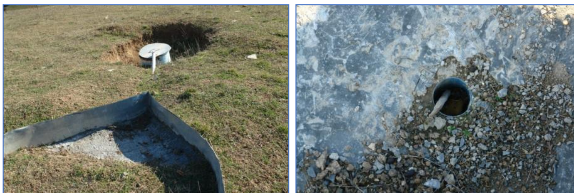
شکل ۶- انسداد ورودی لوله‌های انتقال رواناب و رسوب از پلات‌ها به مخازن پلات‌های فرسایش و رسوب (راست) و عدم پوشش پایاب آن (چپ)
